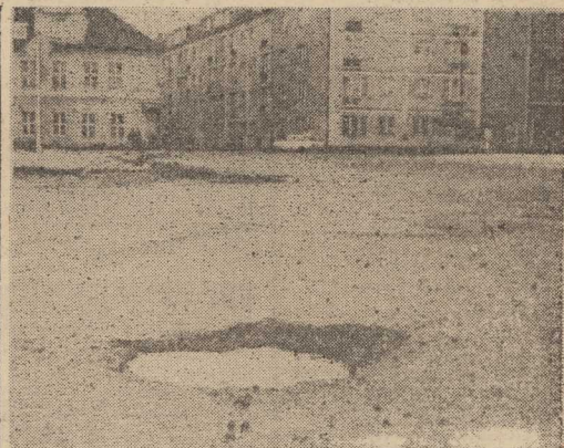
WYSTARCZYŁO kilkanaście dni tegich mrozów by na jez. Szmaragdowym zastyłała cała woda. To niechwilnie położony most (jeśli miał służyć) popękał od wody, która wariła się tam i zamarała. Oj, Przedsiębiorstwo Eksploatacji Dróg i Mostów będzie miało na wiosnę masę roboty!
