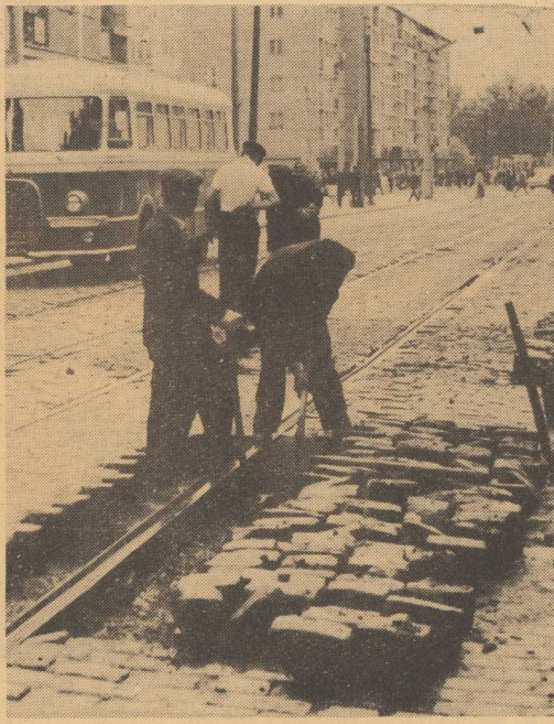
TOROWISKO NA AL. NIEPODLEGŁOŚCI JEST W FALNYM STANIE. MIMO IŻ TAK NIEDAWNO BYŁO REMONTOWANE. TERAZ TRZEBA JE NAPRAWIAĆ PONOWNIE. BRYGADY MPK WŁASNIE PRZYSTĄPIŁY DO PRACY.
