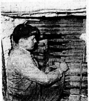
Na zdjęciu monterzy z brzojdy rozruchowej Sarneckiego — Kamiński i Kowalewski przy gotowaniu końcówki rur do uszupiania nowych zestawów.
