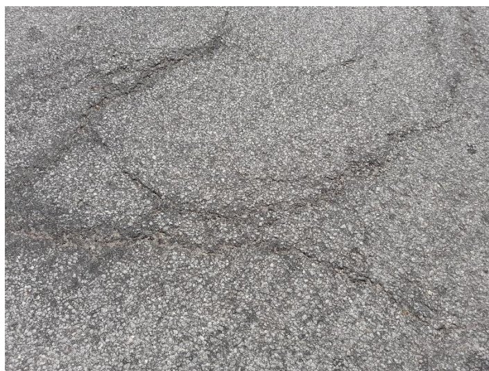
Rys. 2-7. Widok spękania siatkowego
