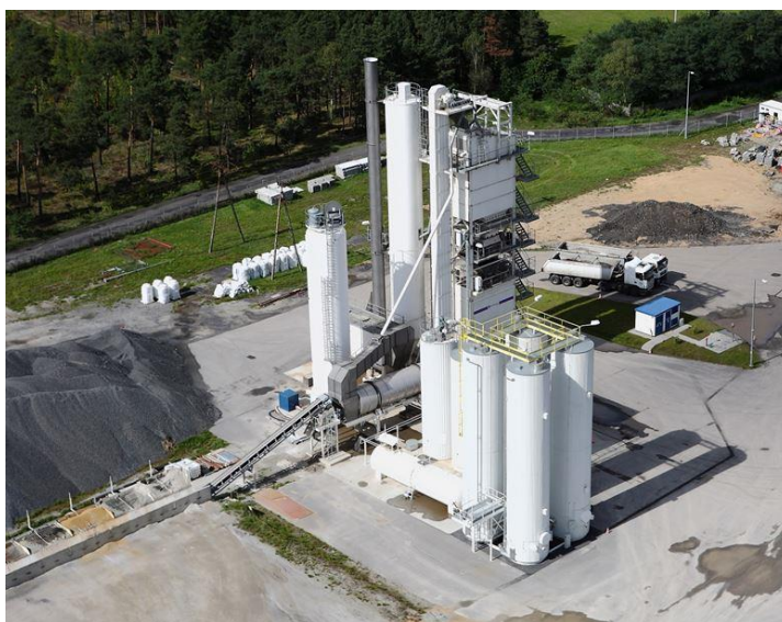
Rys. 3-7. Wytwórnia mieszanek mineralno-asfaltowych Ammann 240 (źródło: Eurovia Polska S.A.)
