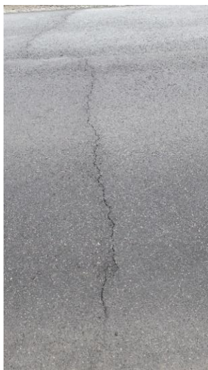
Rys. 2-10. Przykład pojedynczego spękania niskotemperaturowego
