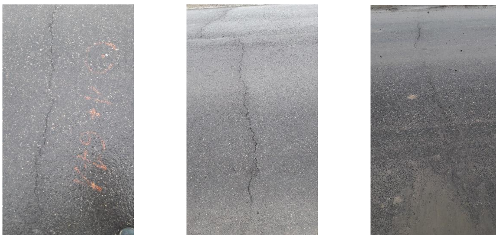
Rys. 5-1. Spękania nawierzchni (warstwy wiążącej) na drodze wojewódzkiej nr 265
