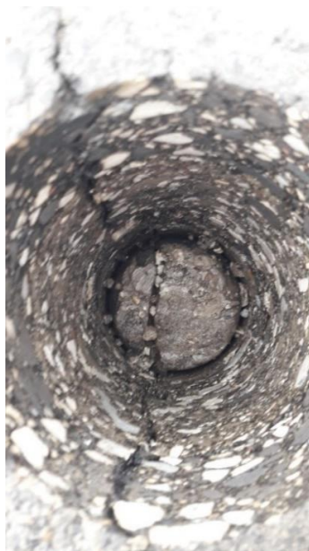
Rys. 5-2. Otwór w konstrukcji z widocznym spękaniem odbitym inicjowanym w warstwie podbudowy pomocniczej z mieszanki stabilizowanej cementem C_{3/4}
