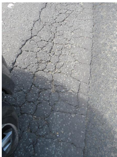
Rys. 2-11. Niskotemperaturowe spękania zmęczeniowe (źródło: tensar.pl)
