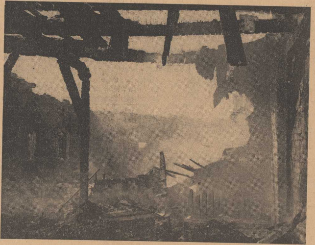
Der ausgebrannte Bodenraum.
