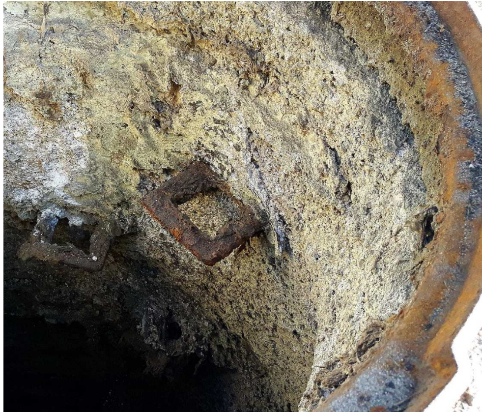
Rys. 2 Skorodowana studnia zaobserwowana podczas badań terenowych (materiał własny Fot. B. Bogusławski)
