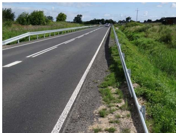
Ryc. 3.36. Bariery ochronne na poboczach drogi wybudowane na dojeździe do wsi Trzebusz 2
