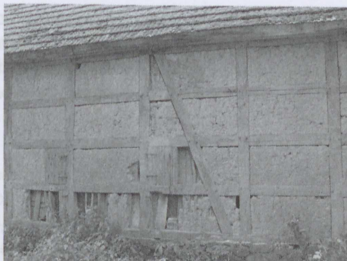
Ryc. 10. Struktura ściany ryglowej: szkielet z dębiny, wypełnienie gliniane na strychulcach – budynek bramny w miejscowości Kluki pod Darłowem (fot. autora)
