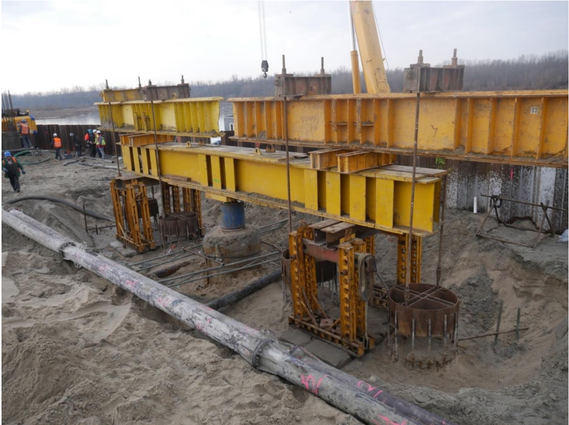
Zdjęcie 5.1 Konstrukcja oporowa przygotowana do wykonania próbnego obciążenia pala (źródło: A. Wasiluk)
