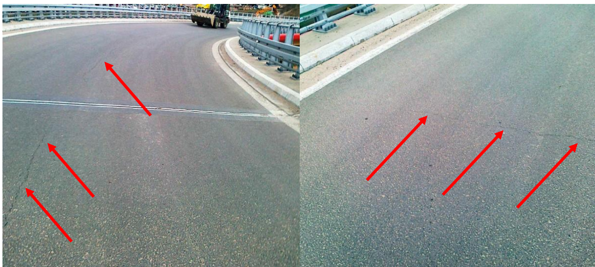
Rys. 2-17 Przykłady uszkodzenia nawierzchni mostowej, pęknięcia podłużne oraz poprzeczne [46]
