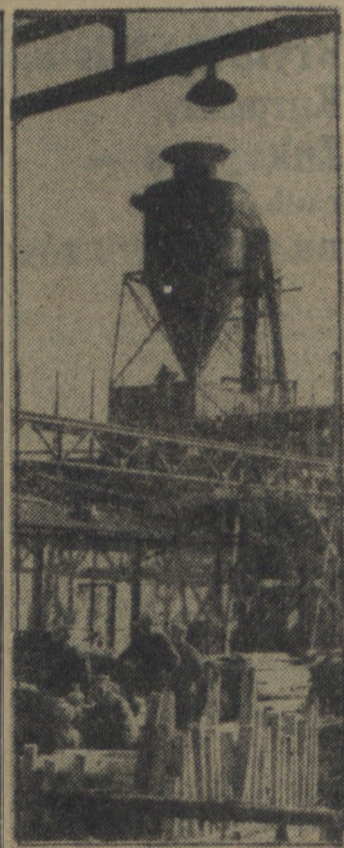
W Stupskiej Fabryce Mebli przystąpiono w tym roku do budowy nowej kotłowni. Roboty są już daleko zaawansowane. W obecnej chwili przygotowuje się części do montażu w gotowym już pomieszczeniu. Nowa kotłownia posiadać będzie urządzenie do automatycznego ładowania paliwa, usuwania smażki itp. Kotłownia zasili wiatną elektrownię, do starczy odpowiednia ilość pary potrzebna do produkcji i ogrzeje zakład. Nadmiar prądu z elektrowni popłynie do sieci miejskiej.
