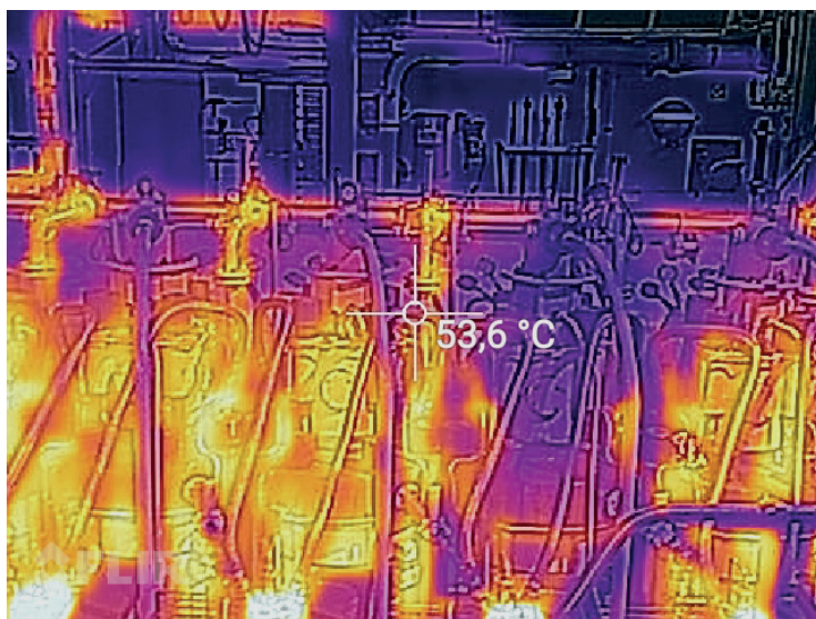
Rys. 4.1. Silnik główny. Temperatura przewodu paliwowego (zrzut z ekranu z programu FLIR Tools)
