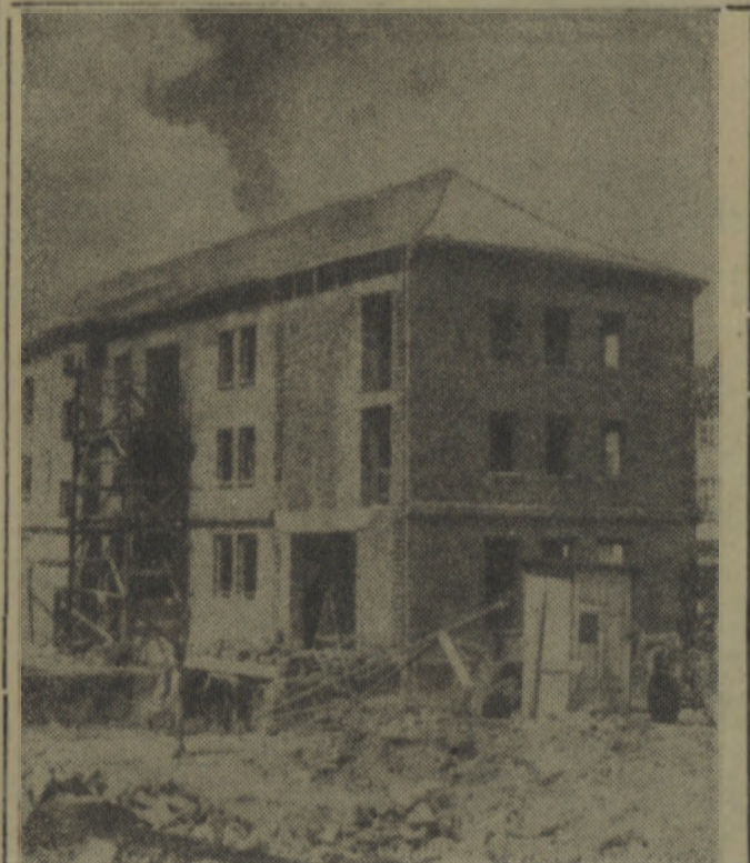
Cieszy nas, że prace przy budowie hotelu postępują nierzadko. Może więc już niedługo Koszalin otrzyma hotel z prawdziwego zdarzenia. Na zdjęciu: hotel w budowie.
