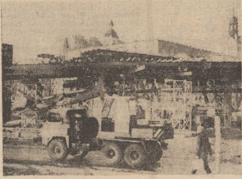
POSTĘPY na budowie Trasy Zamkowej uidać najlepiej ze skarpy zamkowej, skąd rozpościera się znakomita jej panorama. Na wysokości jednak dawnej ul. Wyszcza podziwiać można z bliska wszystkie konstrukcje łącznie z wysokościami wież jęzdni. Fot.: Z. Jodkowski
