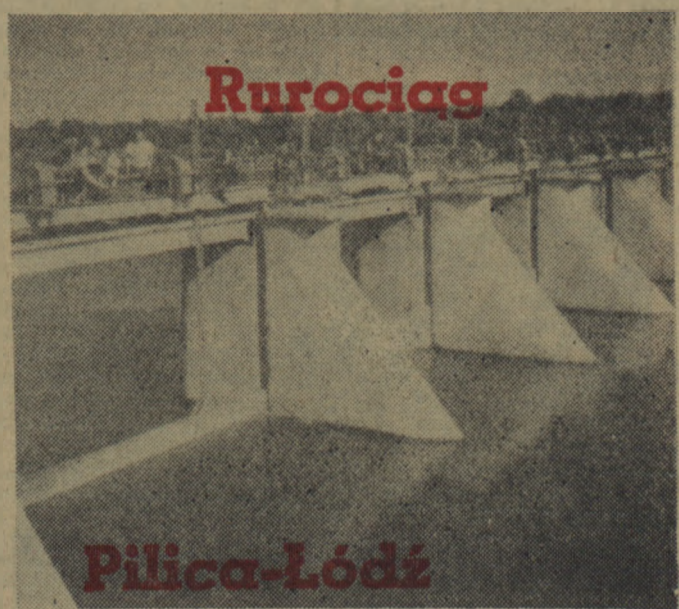
Na zdjęciu: stacja ujęcia wody na Pilicy.
