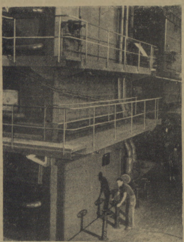
Jedną z najbardziej nowoczesnych elektrowni w Niemieckiej Republice Demokratycznej jest elektrownia w Stalinstadt. Trzy silne turbiny wytwarzają prąd wystarczający do zaopatrzenia miasta liczącego 600 000 mieszkańców.
