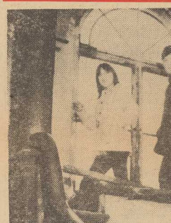
NA ZDJĘCIU U GÓRY: A oto fragment klatki schodowej w budynku przy ul. Malopolskiej 60, należącym do ADM nr 2. Ta zniszczona barierka leży już od kilku dni. Nie nie pomogła interwencja dozorczyń w ADM. Powiedziano jej „to się robi”. Dotychczas jednak żadnego efektu nie widać. Może ADM nr 2 czeka, aż zdarzy się tam jakiś wypadek? (tur) Foto: A. WITUSZYŃSKI
