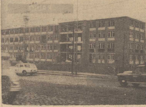
PRZY ul. Energetyków rośnie budynek nowej siedziby dla powiatowego. W grudniu br. obiekt ma zostać oddany do użytku. Wykonawcą jest Nadodrzańskie Przedsiębiorstwo Budownictwa Przemysłowego. Fot.: Al. Wituszyński
