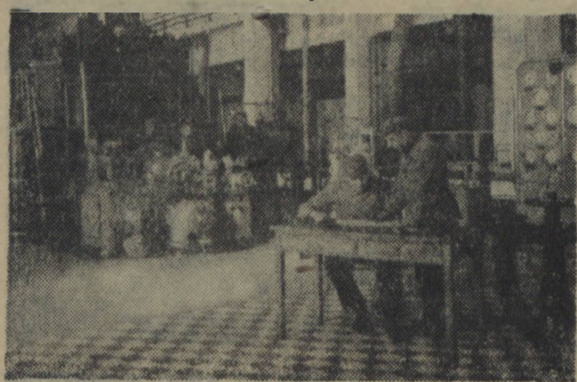
Budowa silowni Jaworzno II — największej inwestycji energetycznej — zbliża się ku końcowi. Pozostały jeszcze do montażu i uruchomienia dwa ostatnie kotły i turbospolny. Na zdjęciu: kierownik turbospolowni Stanisław Bednarek kontroluje wraz z maszynistą Zygmuntem Zwiersyńskim pracę nowego turbospolny.
