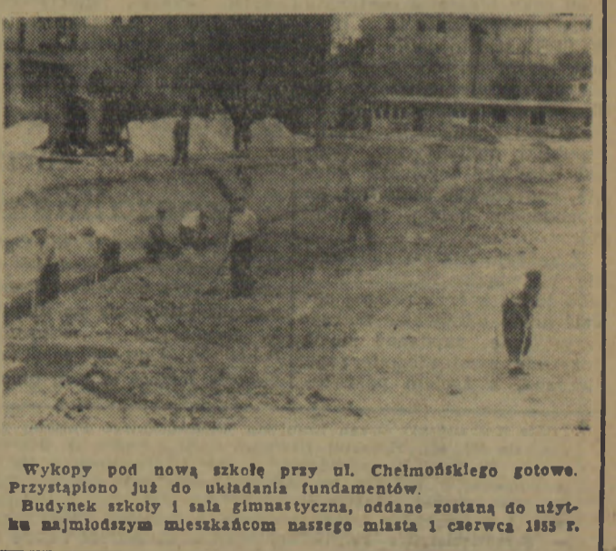
Wykopy pod nową szkołę przy ul. Chelmońskiego gotowe. Przystąpiono już do układania fundamentów. Budynek szkoły i sala gimnastyczna, oddane zostaną do użytku najmłodszym mieszkańcom naszego miasta i czerwca 1955 r.
