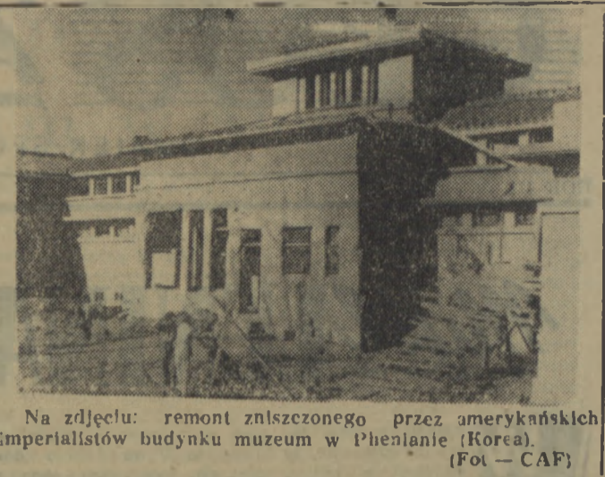
Na zdjęciu: remont zniszczonego przez amerykańskich imperialistów budynku muzeum w Phenianie (Korea). (Fot — CAF)
