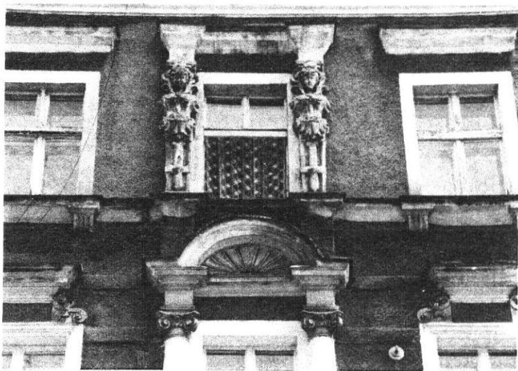
Fot. 47. Fragment elewacji jednego z budynków drugiego zespołu z zachowanym detalem. Źródło: zdjęcie autora
