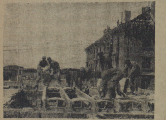
Wielu budowlanych osiedla robotniczego Im. S. Wierczorka koło Piekar Śląskich w pełni doceniając uporządkowanie systemu płac i norm w budownictwie, podjęło ochotniczo pracę wg. nowego taryfikatora.
