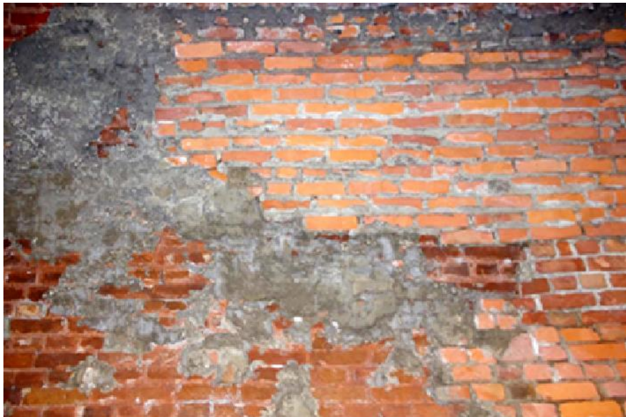
Rys. 3.10 Przykład zdegradowanego muru ceglanego
