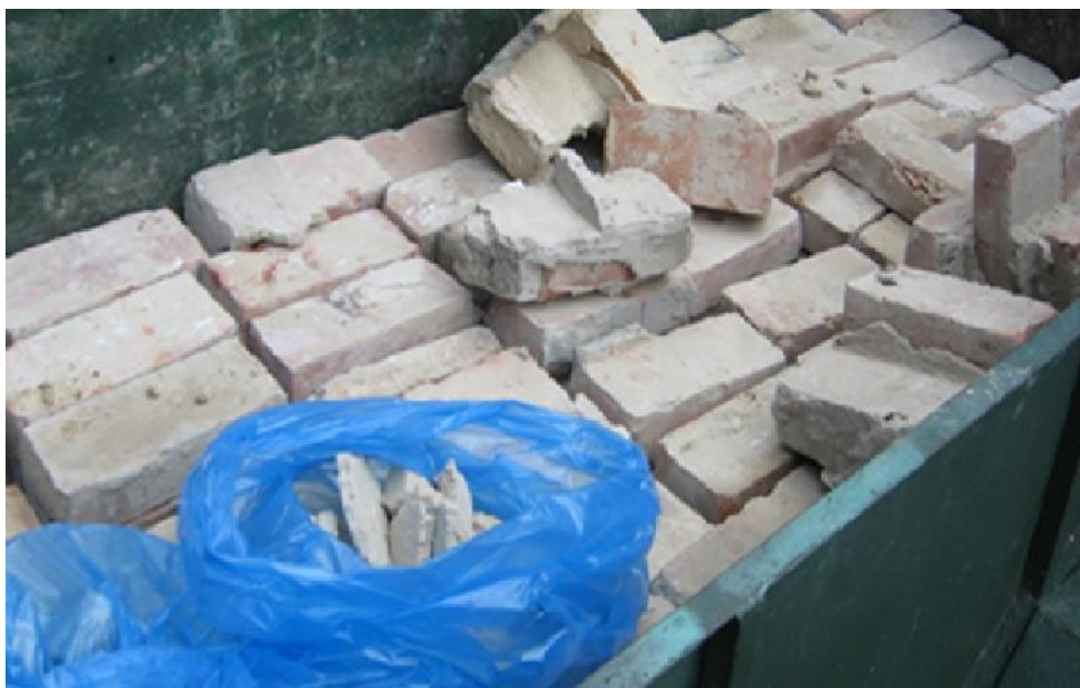
Rys. 4.3 Cegła i zaprawa pobrane do badań wytrzymałościowych murów z wyburzanej szkieletowej kamienicy
