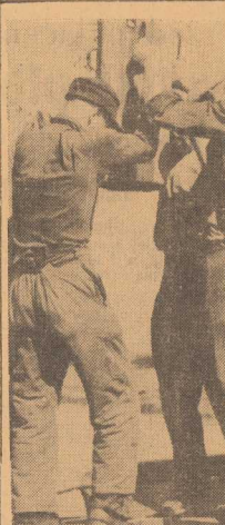
MIAROWO stuka ręczna „babka“, wbijając kawałek po kawałku w dno przystanku żeglarskiej Parku Sportowego na Regulacji ogromne pale, które za umocnią nabrzeża. Nie szczęda są robotnicy Józef Miry, Stefan Męzka, Kazimierz Antszak i Bronisław Woźniak z Technicznej Bazy Portowej, z bawianiem portowców musi być bawianiem zrealizowane w terminie, a na przystanku czekają już żeglarskie Kolejarz. O realizowaniu czynu przez sportowców szczecińskich Portu dowiecie się z reportażu na stronie 3.
