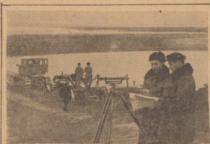
W CELU zapewnienia stałych dobrych urodzajów w okolicach stępych i t-powolniejszych, dla prowadzenia wsi ki z kleską suszy zakłada się w kolechoch Zw. Radzieckiego ochronne pasy lasne i tworzy zbiorniki wody. Na zdjęciu: Prace przy zakładaniu stawów w kolechozie „Leniowski Związek cięstwo”, dzięki którym nawodni się dziesiątki hektarów ziemi. (Fot. — CAF).
