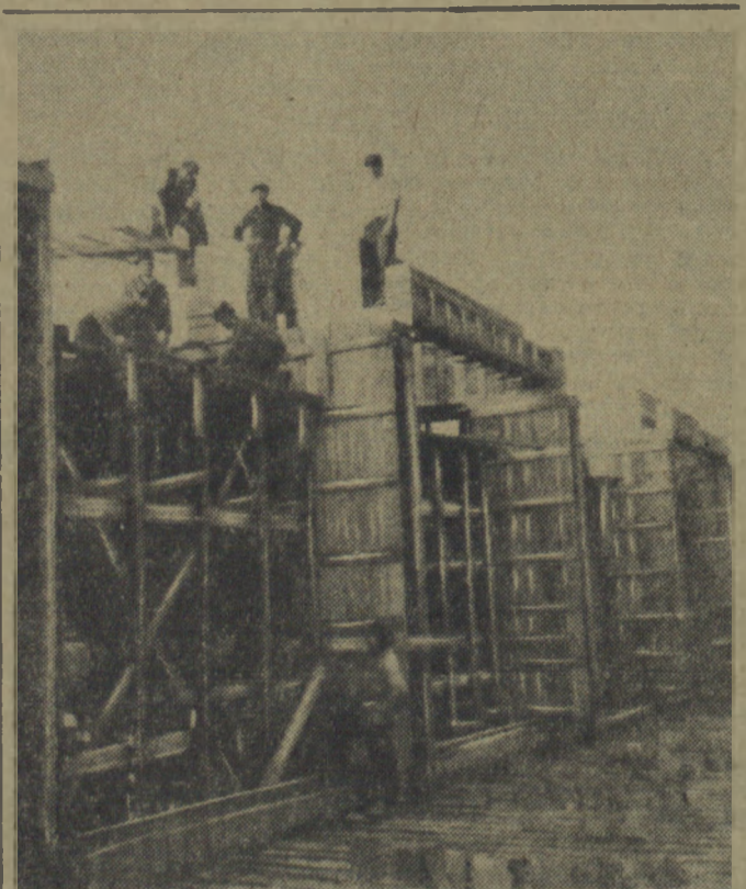
Budowa nowoczesnej kopalni „Wesoła II“ postępuje szybko naprzód. Na zdjęciu: produkująca brzoza cieszlińska Antoniego Witaska osiągnęła w ostatnim miesiącu 800 proc. normy.
