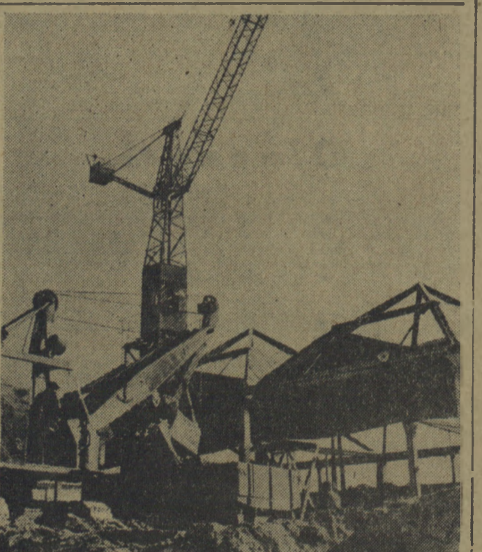
Budowa Fabryki Armatury w Borku Falckim pod Krakowem postępuje szybko naprzód. Hala nowej fabryki budowana są według planów polskich inżynierów i wykonywane wyłącznie z prefabrykatów betonowych, co w efekcie daje ogromne oszczędności materiałowe w żelazie i w drzewie. Oszczędność żelaza wyraża się cyfrą 11 kg na 1 m. kw. powstających budynków. Na zdjęciu: fragment budowy. Na pierwszym planie kopaczka radziecka wybierająca ziemię z wykopu pod stację pomp.
