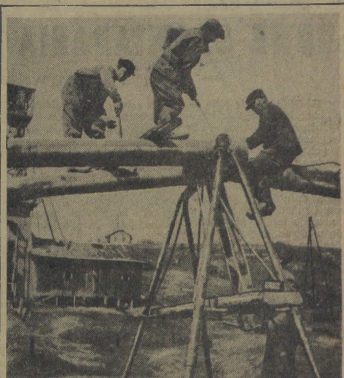
Budowa nowego szybu naftowego w trzecim zespole Kopalni Kroszonińskiego. W głębi stary szyp przeznaczony do rozbiórki.
