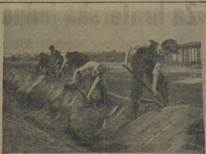
Uczniowie szkół warszawskich — junacy SP rozpoczęli prace społeczne. Na zdj.: Członkowie hufca SP ze szkoły im. Poniatowskiego wykonują prace niwelacyjne na rejonie ulic Elbląskiej i Przemyskiej.
