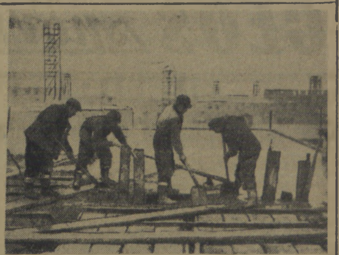
Realizując podjęte zobowiązania, budowlani Nowej Huty wysoko przekraczają normy. Brygada betoniarzy tow. Romana Kędziolki, pracując przy budowie odcinka C-2 w Nowej Hucie, osiągnęła w ostatnim okresie obrachunkowym (1-15. I. 1951) 212 proc. normy. Na zdjęciu: członkowie brygady Kędziolki przy pracy; w tle widoczny las rusztowań szybko budującego się miasta.
