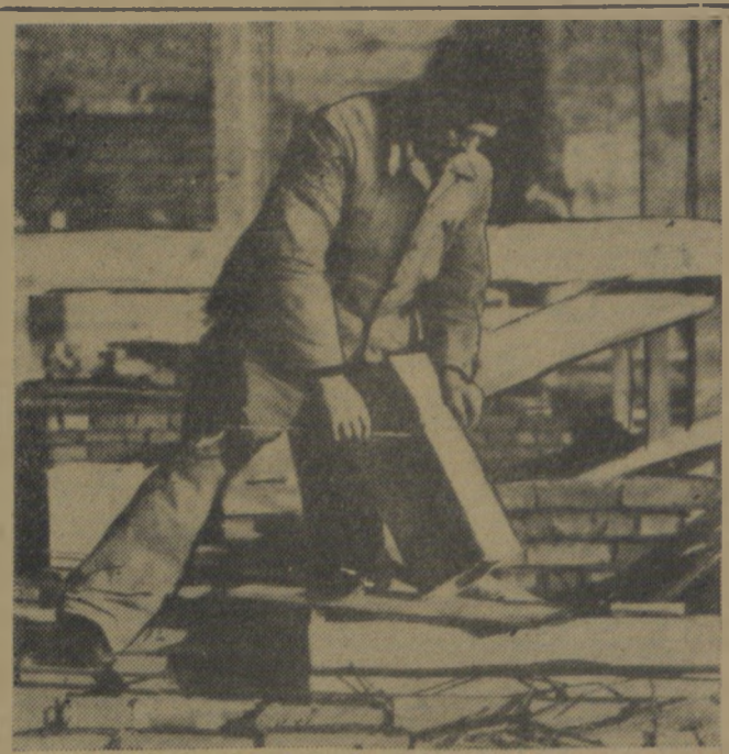
Czesław Adamski, brygadzysta ciesielski z budowy bloku 2a na MDM, zobowiązał się wraz z brygadą przekraczać stale 200 proc. normy i wezwał do współzawodnictwa cieśli zatrudnionych przy budowie bloku 3a. Brygada Adamskiego wykonała w ostatnim okresie obliczeniowym przeciętnie 230 proc. normy.
