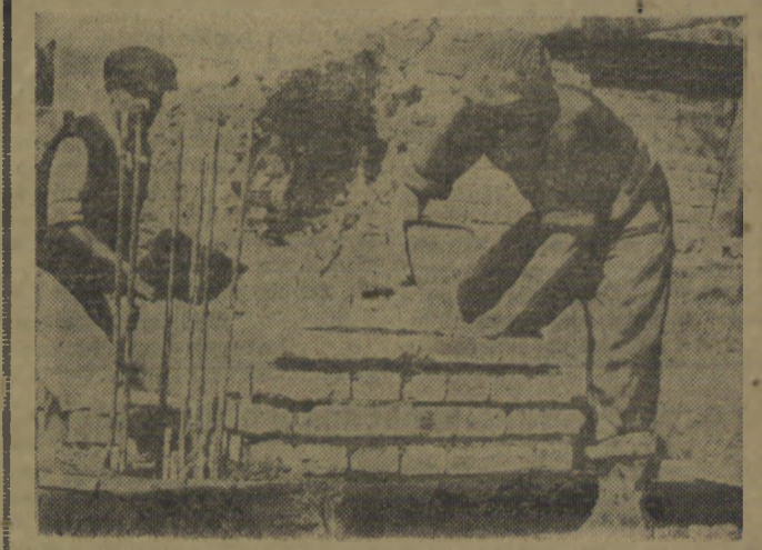
Dnia 6.X. br. pracujący przy budowie bloku 3-a na MDM murarze Fr. Witke i Wł. Górecki wraz z pod-ręcznym S. Kożą i F. Kędziorkiem położyli w ciągu 8 godzin pracy 32 m sześć muru. Na zdj.: F. Witke i St. Koża przy pracy.
