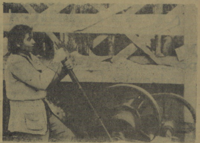
Apolonia Sermanowicz odciąża do tyłu przekładnię windy i nowa partia materiałów wjeżdża na dach budowanego gmachu.
