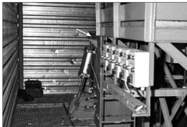
Ryc. 1. Miejsce, w którym doszło do wypadku. Strzałka pokazuje klapę hydrauliczną
